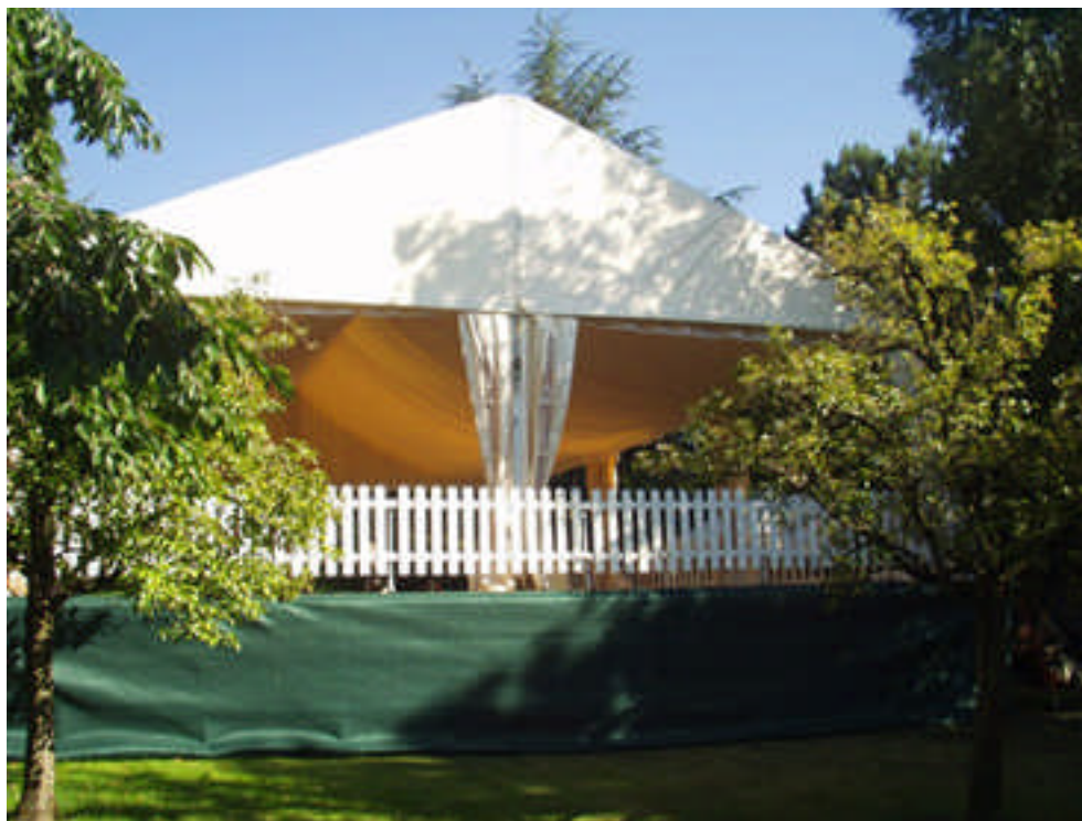
Vue avant, avec habillage de la structure et pose de barrières de sécurité
